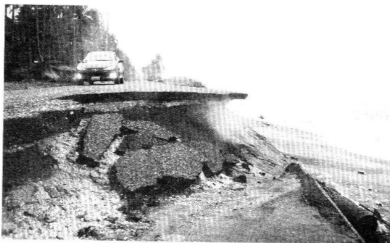
Las lluvias han dañado parte de la red carretera.
