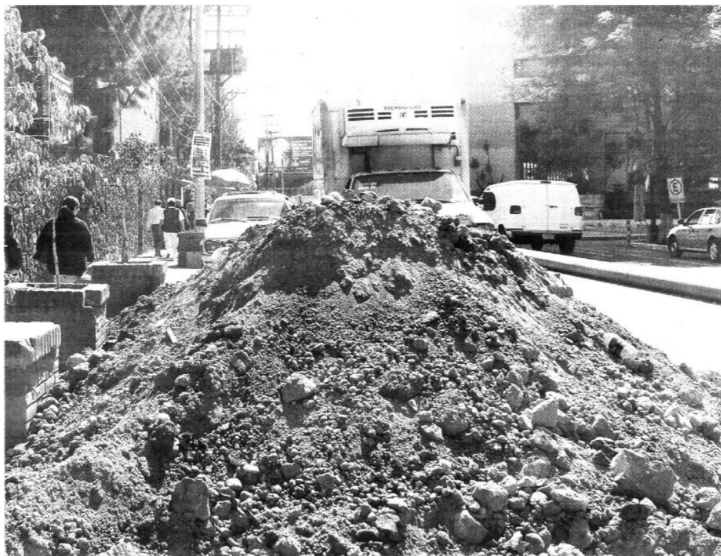
Montañas de tierra y cascajo que han generado los trabajos obstaculizan en la red hidráulica no sólo el flujo vehicular, sino el paso de transeúntes
