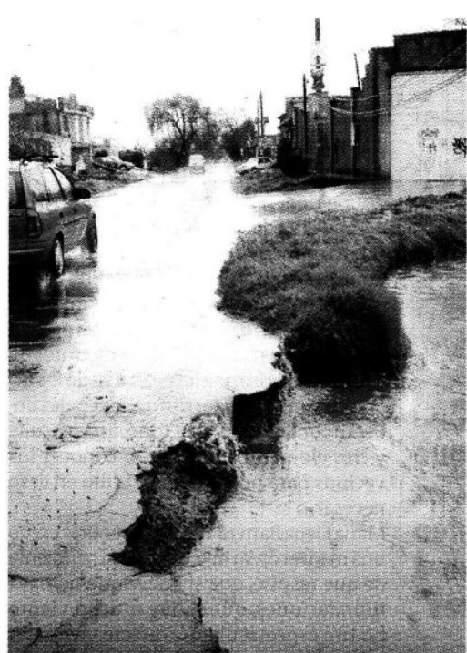
Avenida Lerma: las calles resienten la fuerza del agua
