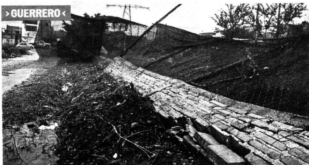
En Guerrero, el saldo de las lluvias es de al menos 51 familias evacuadas y 120 casas dañadas por deslaves e inundaciones en Chilpancingo, Juan R. Escudero, Coyuca de Benítez, Acapulco, Zihuatanejo y Ajuchitlán.
