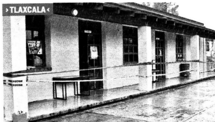
En Tlaxcala se reportó el desalojo de una escuela de la comunidad de Tepehitec, debido a que está a punto de colapsar por las fuertes lluvias.
