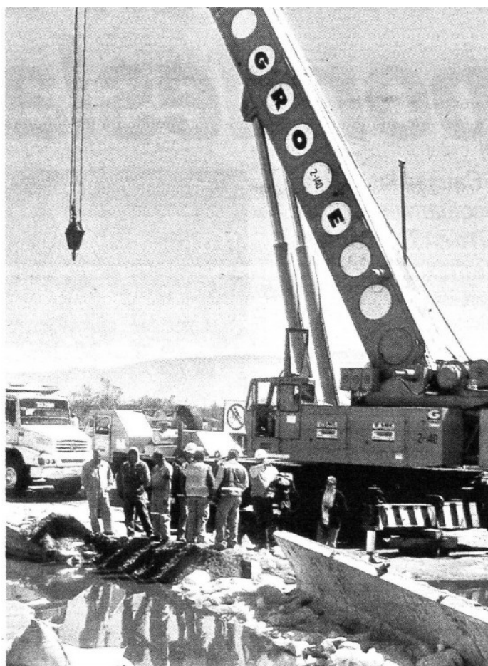
Autoridades controlaron provisionalmente la fuga de aguas negras en el Río de los Remedios. Las vigas metálicas reforzarán el bordo.
