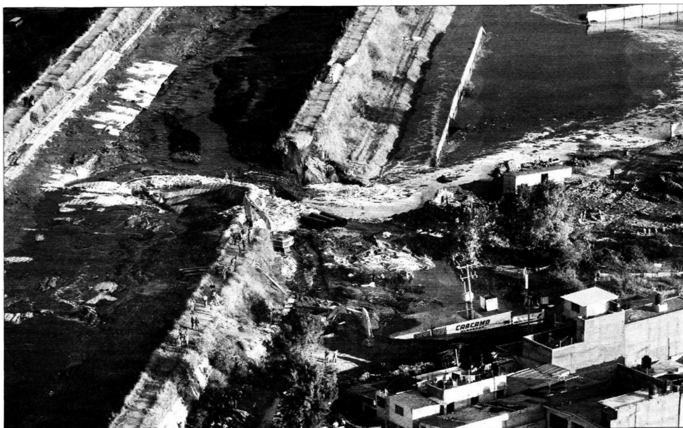
Aspecto de la fractura en uno de los muros de contención del canal de aguas negras La Compañía, ubicado en Valle de Chalco ■ Fotos de Alfredo Domínguez
