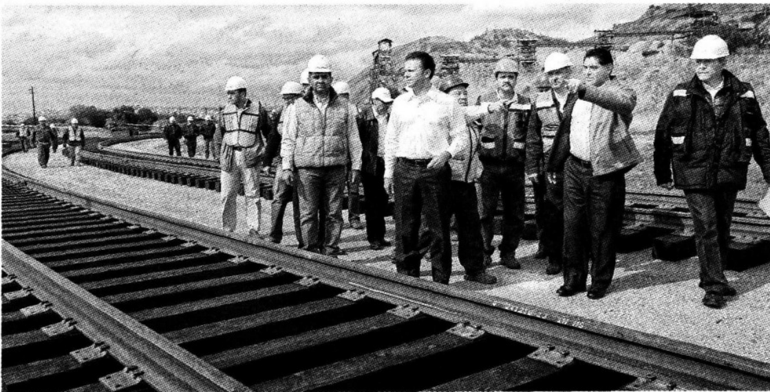
Acompañado por el alcalde Esteban Villegas, el gobernador Jorge Herrera Caldera supervisó los trabajos de construcción del periférico ferroviario
