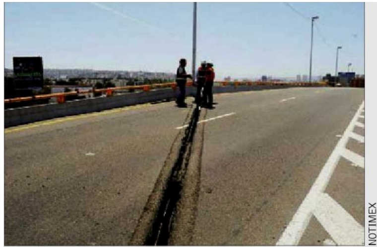
DESPERFECTO. Autoridades revisan la separación que sufrieron las placas del puente.
