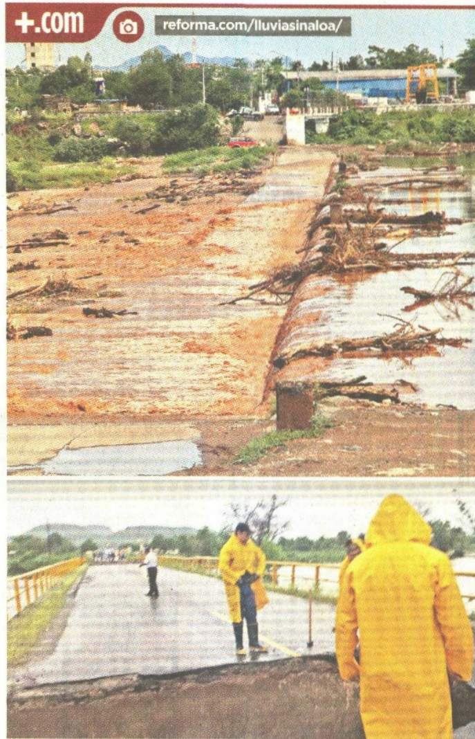
ARRASA. Una lluvia de cuatro horas continuas desbordó ríos y dañó infraestructura vial en Sinaloa.
