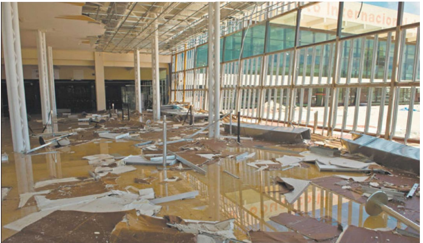
Concreto y acero. Sólo las estructuras hechas con materiales más sólidos y resistentes soportaron el embate del viento y el agua que llevó Odile a Baja California Sur. FOTO: AFP
