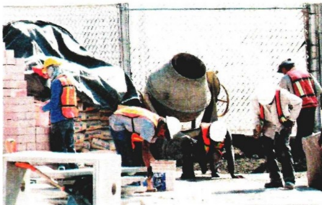
Algunas empresas trabajan con precios bajos con el afán de ganar contratos y licitaciones en obras.
