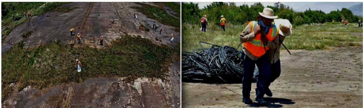
PISO PAREJO. Algunos trabajadores contratados por el Grupo Aeroportuario de la Ciudad de México ya realizan estudios geotécnicos de los terrenos para comenzar su limpieza, dragado y el trazo de caminos provisionales para el acarreo de basura y escombros.
