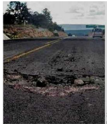
La autopista Durango-Mazatlán requiere obras para reparar los baches.
