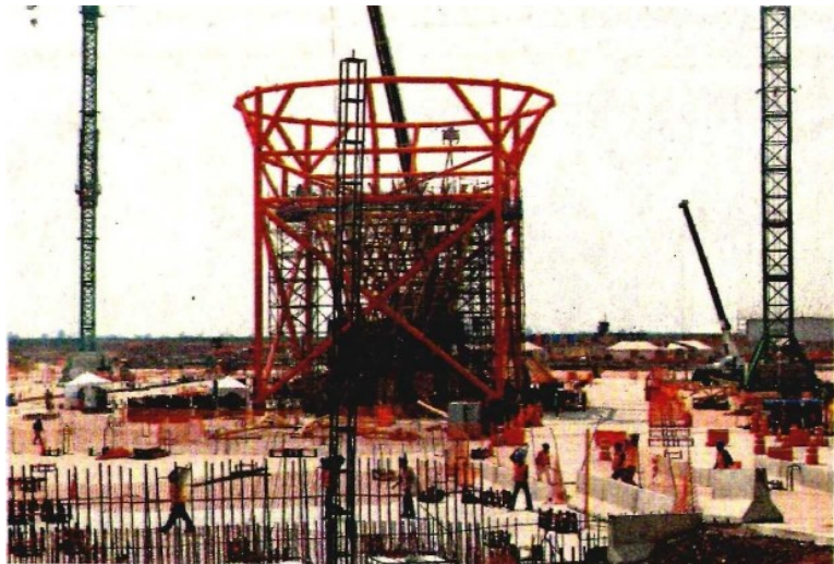
En la megaobra se emplean 45 mil personas para la construcción del proyecto; se espera que la cifra ascienda a 70 mil al final del año.
