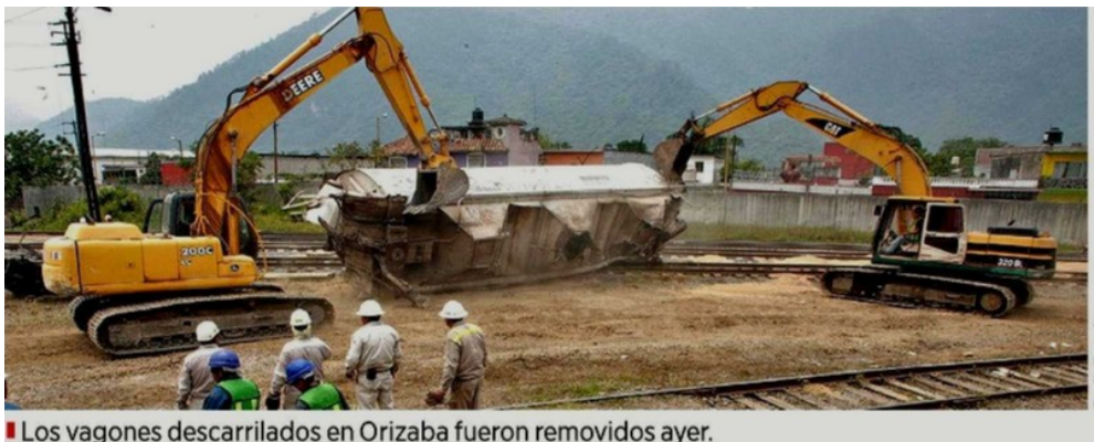
Los vagones descarrilados en Orizaba fueron removidos ayer.
